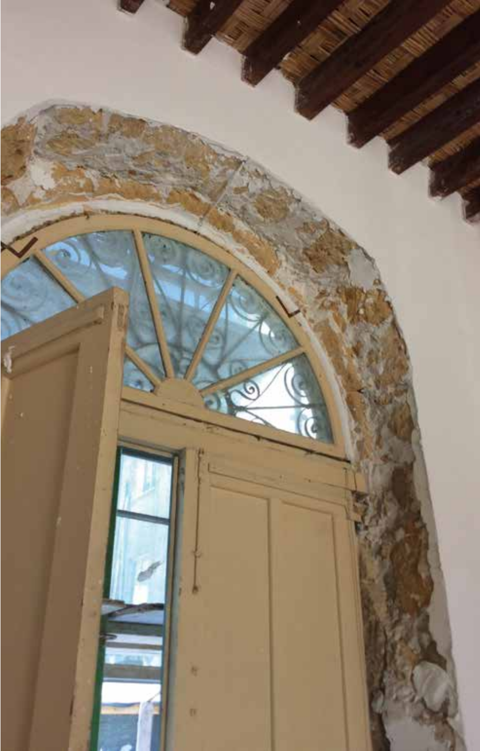
Şekil 12g: Restorasyon öncesi yapının giriş kapısının durumu (Menteş, 2015)
