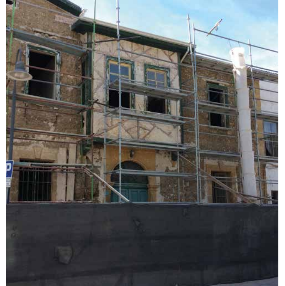
Şekil 11a: Restorasyon öncesi yapının cephesinin durumu (Menteş, 2015)
