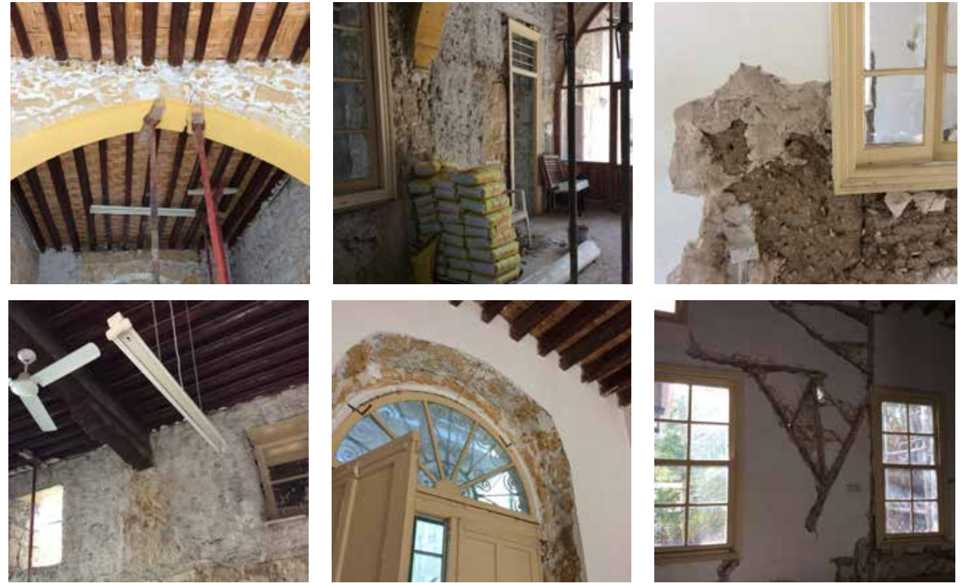
Figür 6. Restorasyon öncesi, binanın içindeki nitelikli mimari elemanlarının durumu. (Menteş, 2015)
